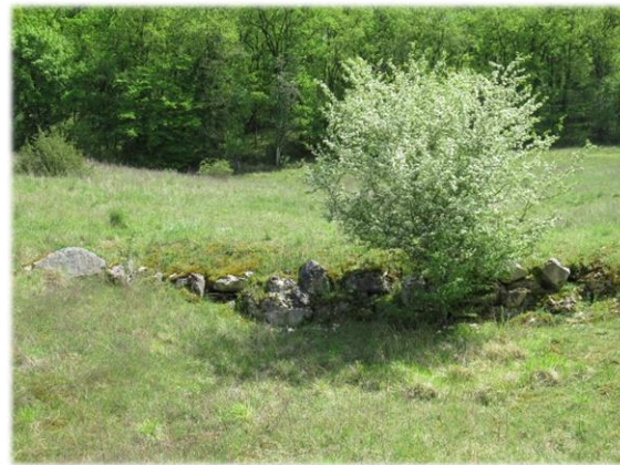
Chemin enroché présentant des cavités
